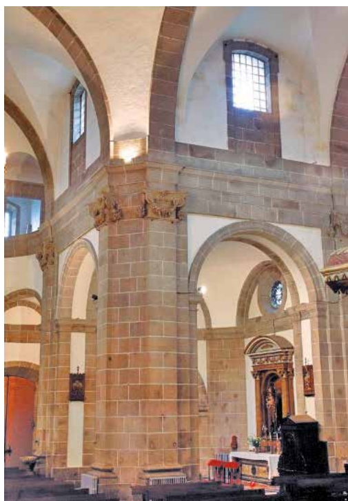
Algunos de los arcos que irían en ladrillo y van en piedra. Foto de Kiko Delgado.
