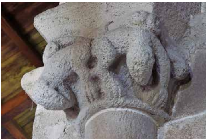
Ilustración 8. Capitel de pilar nave del evangelio. [H].
