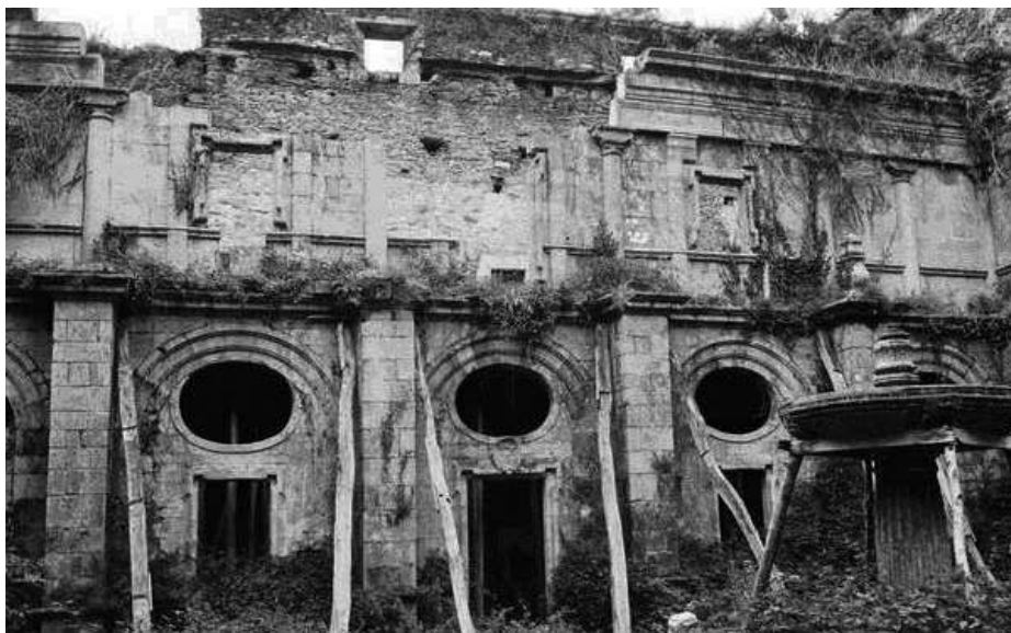
Fotog. 9. Estado apuntalado do claustro regular tra-la desamortización de Mendizábal. Fonte: Arquivo fotográfico da Real Academia Galega de Belas Artes.
