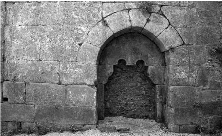
Fotog. 2. Antiga porta románica no muro da nave lateral sur que comunicaba a vella igrexa co claustro existente.
