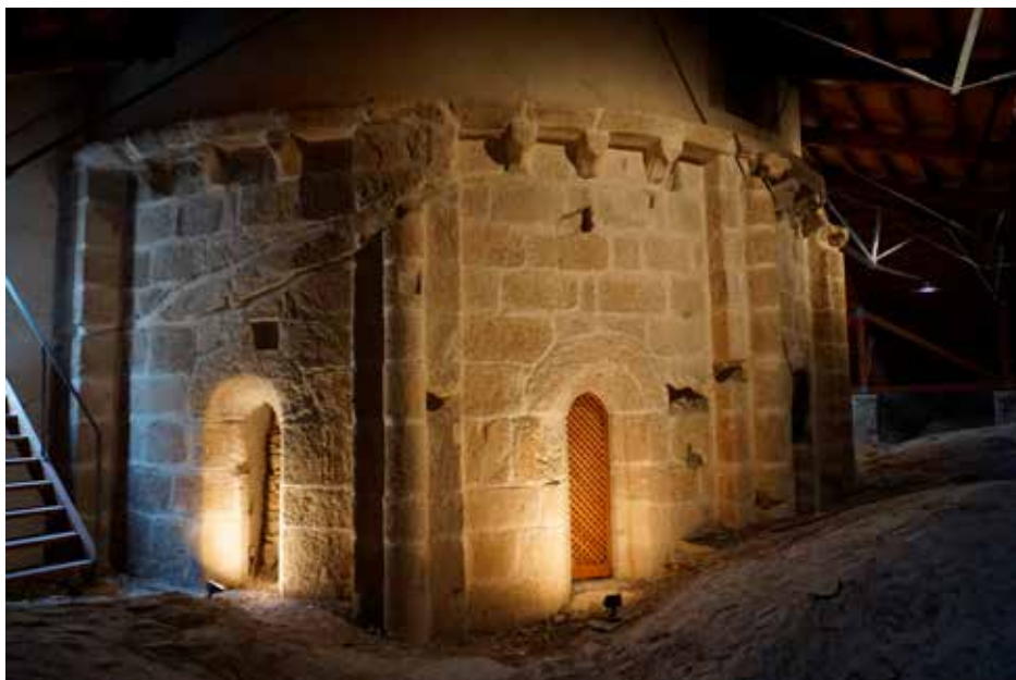
Fig. 3. Muro exterior del ábside medieval que se conserva bajo las cubiertas de la cabecera (Fondo JRLC).
