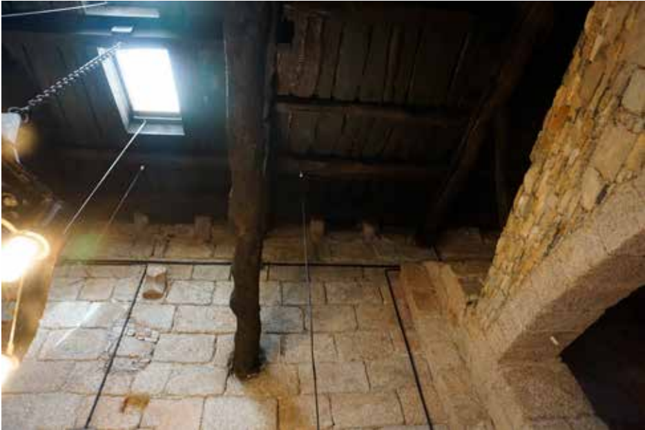
Fig. 13. Detalle de uno de los arbotantes del tercer tramo de la nave de la Epístola donde se aprecia cómo no está apoyado y no trabado con el contrafuerte (Fondo JRLC).
